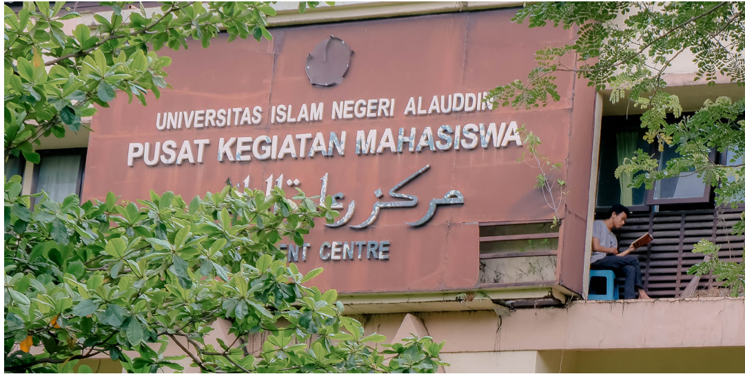
Kondisi gedung PKM dari depan yang menanti perbaikan, Sabtu (13/12/2024). | Foto: Washilah - Aa Min Abduh.
