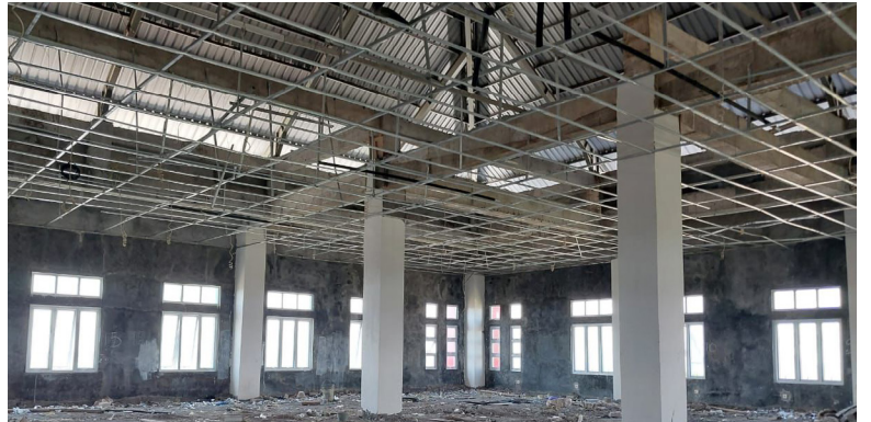
Di lantai delapan, belum dipasang plafon hanya terdapat rangka. Sampah juga terlihat berserakan, mulai dari sampah plastik hingga sisa bahan bangunan.
